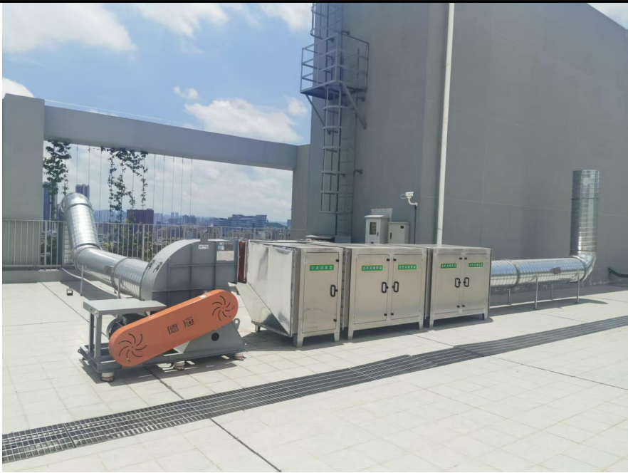
现场废气净化治理设施图
